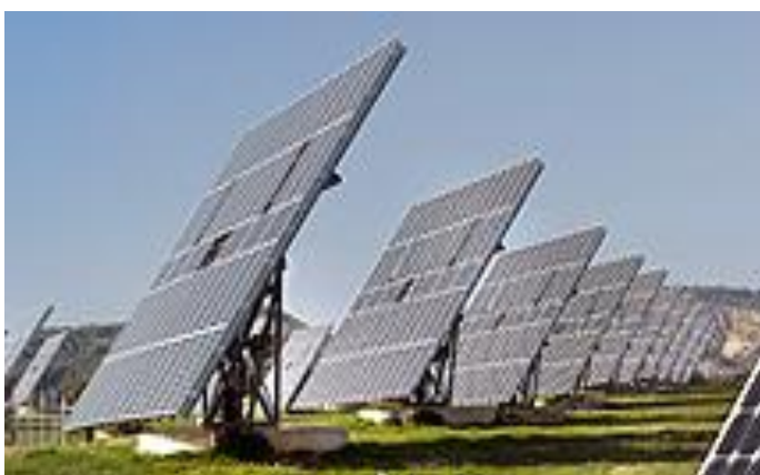
Slika 29: Sončna elektrarna v Španij, v provinci PONTEVEDRA
